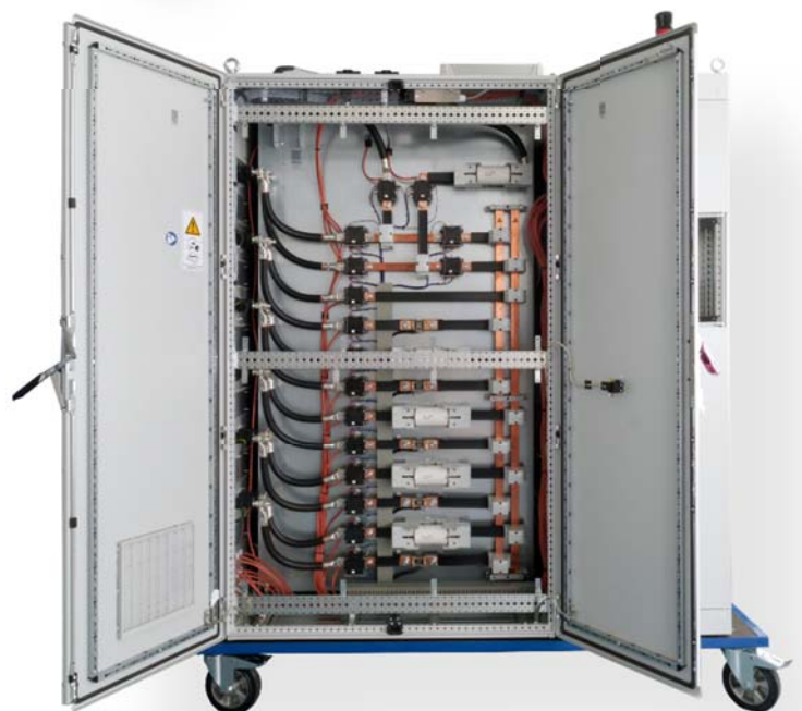
Hochleistung-Schütze zur Verschaltung einzelner Batteriemodule.
